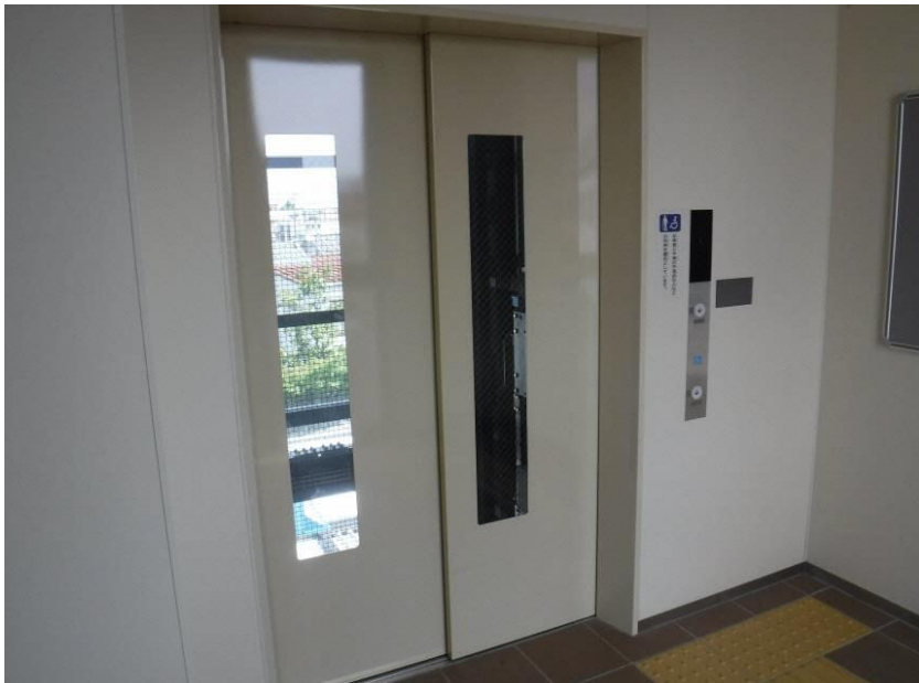
写真 五泉中央連絡橋のエレベーターの整備状況
