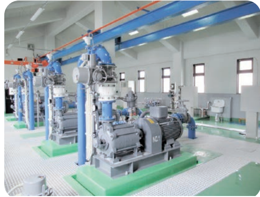
送水ポンプ室(村松浄水場)
