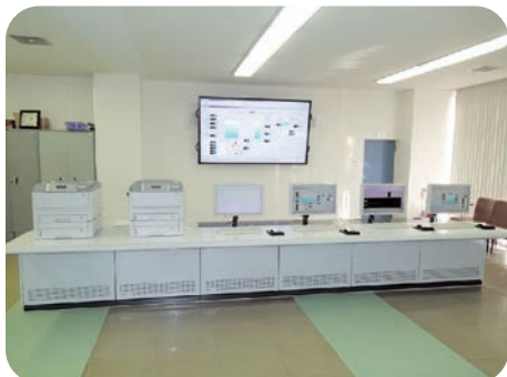
中央管理室(五泉浄水場)
