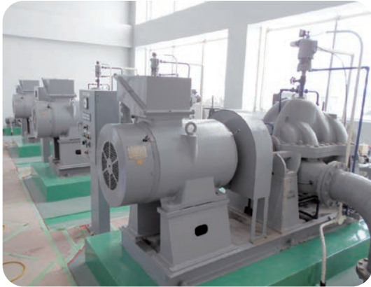
送水ポンプ室(五泉浄水場)
