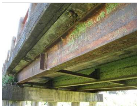
鋼桁の腐食等
