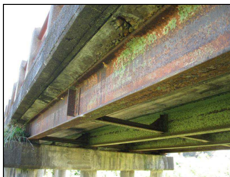
鋼桁の腐食等
