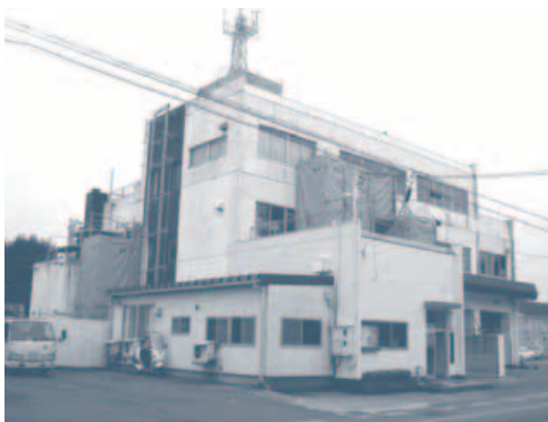
老朽化が進む市の施設
