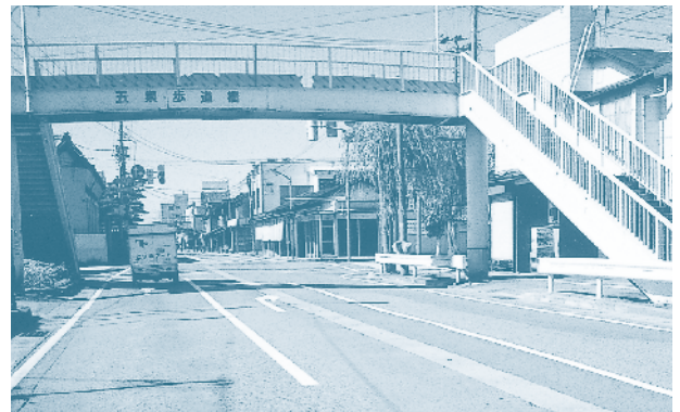
老朽化した歩道橋
