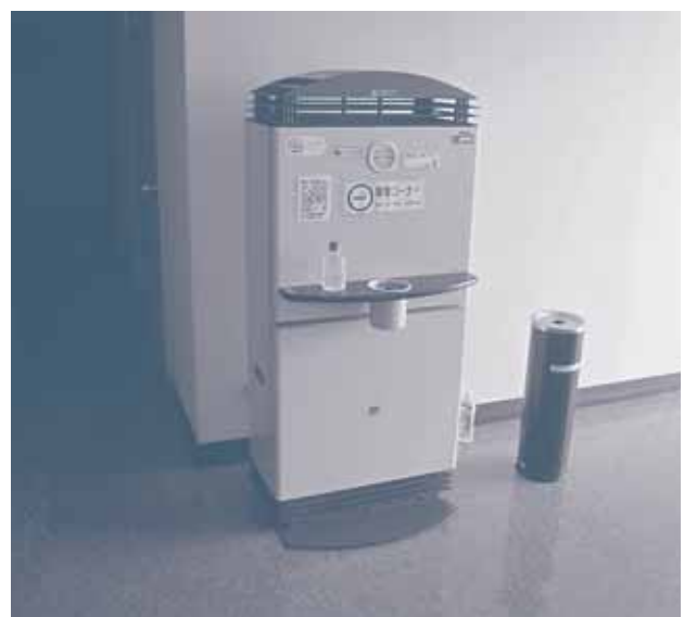
庁舎内に設置の空気清浄機
