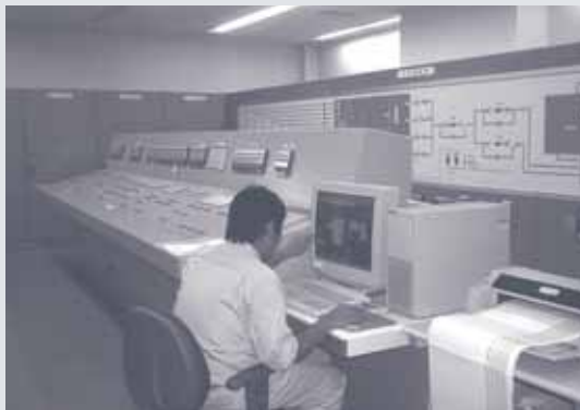
24時間安定供給をめざす（村松浄水場）
