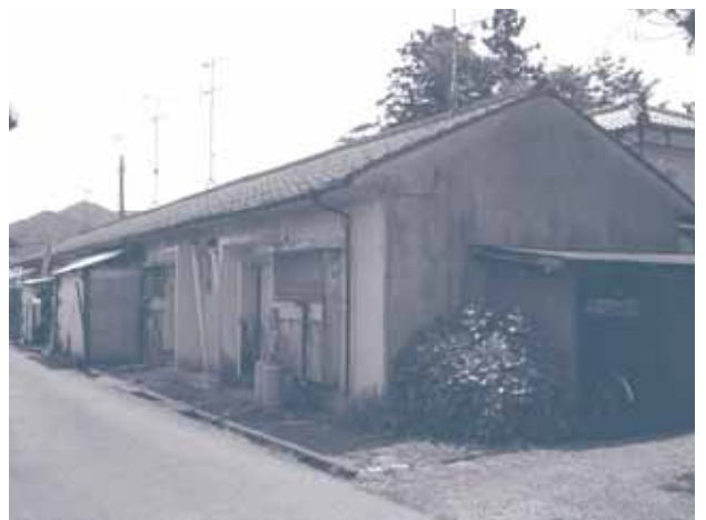
老朽化している市営住宅（川瀬第1住宅）
