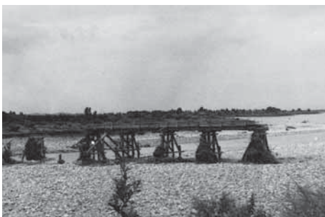
▲濁流により両端を失い、中央部だけ残った不動堂橋（不動堂地内）
