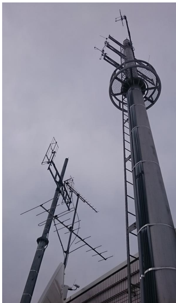
五泉市消防本部屋上の消防無線局
