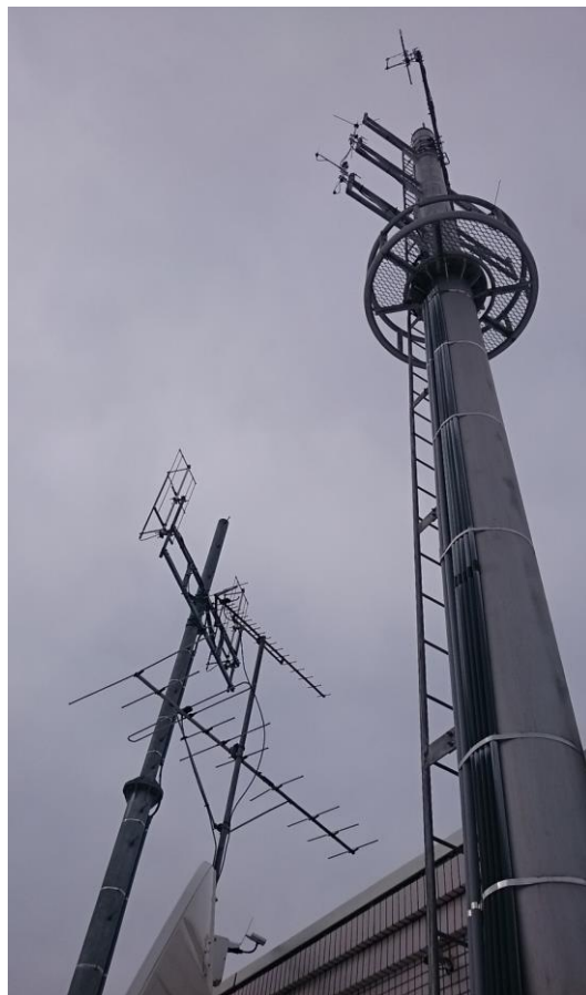
五泉市消防本部屋上の消防無線局
