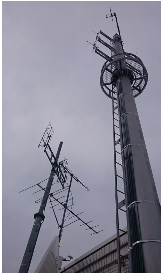
五泉市消防本部屋上の消防無線局
