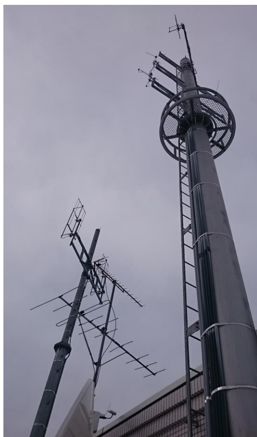
五泉市消防本部屋上の消防無線局
