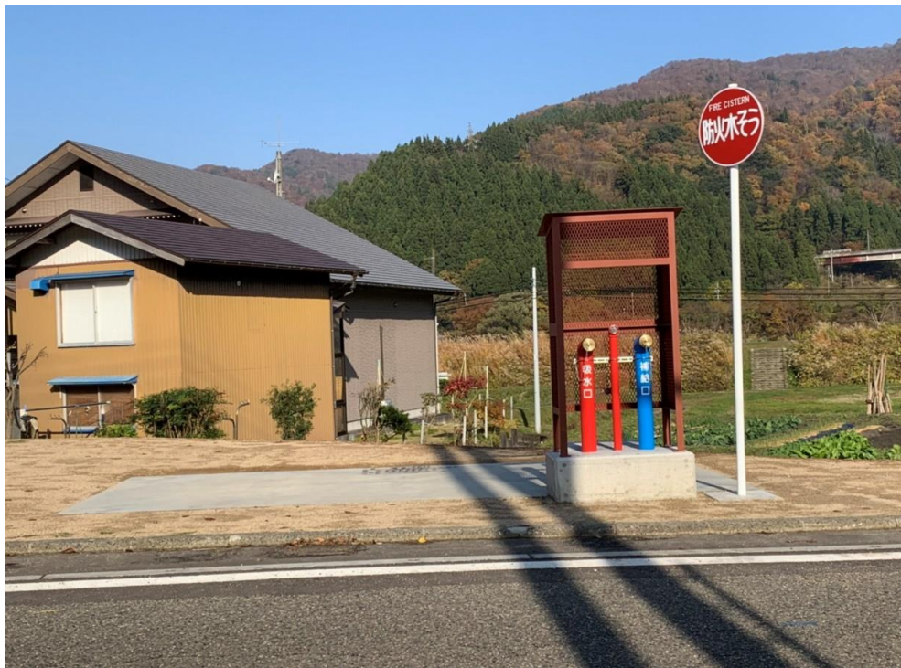
新設した耐震性貯水槽40m 3 型(佐取)
