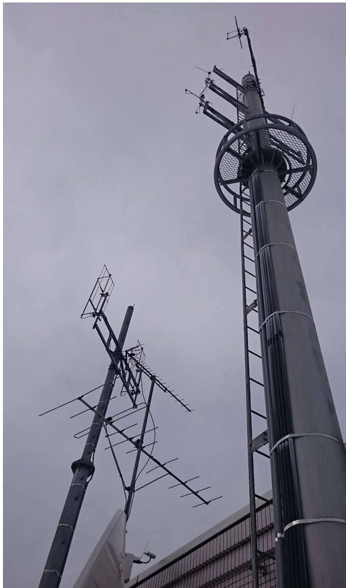
五泉市消防本部屋上の消防無線局
