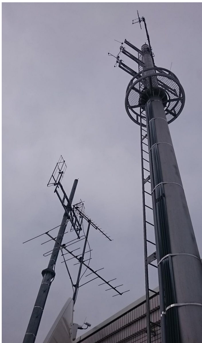
五泉市消防本部屋上の消防無線局
